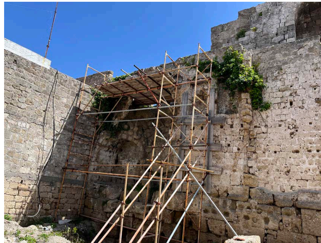
Εικ 3. Άποψη κατάρρευσης-Διακρίνεται η προσωρινή στήριξη-υποστήλωση του τμήματος του τείχους
